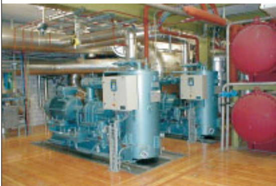
Bild links: Wärmepumpen-Anlage DSM Teranol, Lalden VS
