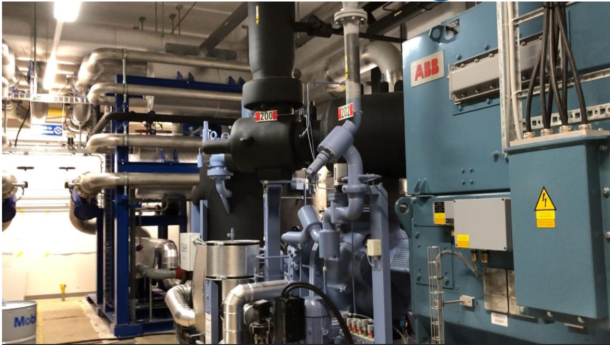
Wärmetauscher Skid mit WP Verdichter
